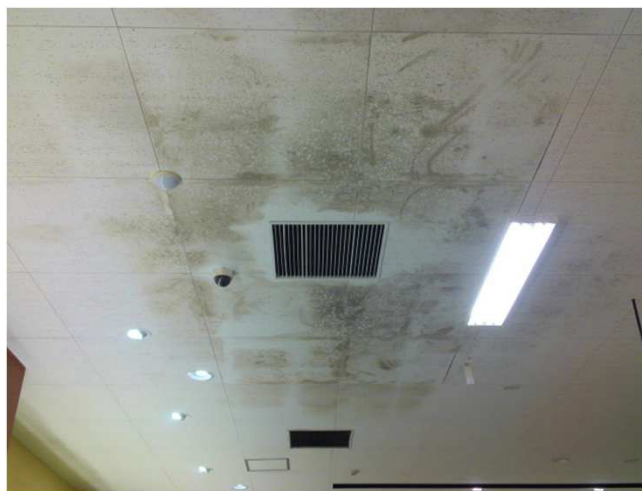
給排気・空調設備まわりはカビが発生しやすい場所です
