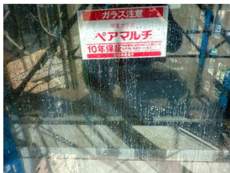
①施工前：撥水状態で汚れが付着しています
