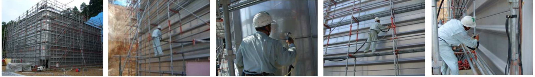
水道局タンク(岐阜) 2008年8月
